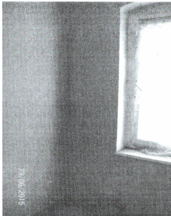
Fot.5,6. Pokryte pleśnią ściany mieszkania nr 2.
