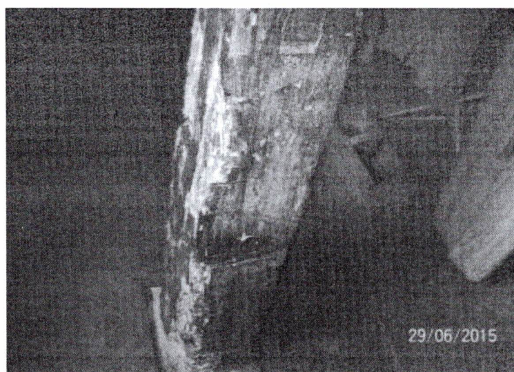
Fot.11. Zniszczony przez korozję biologiczną słup więźby dachowej.
