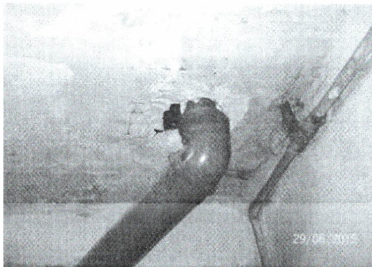
Fot.19. Uszkodzone tynki i zniszczone powłoki malarskie na sufitach klatki schodowej.
