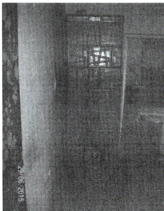
Fot.13. Zniszczony piec w pokoju mieszkania nr 11.
