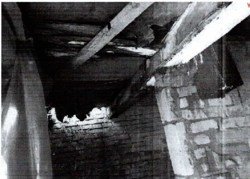
fot. nr 3 Wnętrze budynku – fragment dachu budynku zarwany, w pozostałym zakresie znacznie naruszony.
