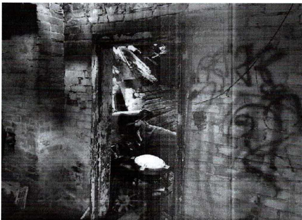
fot. nr 4 Wnętrze budynku – degradacja ścian, znaczna ilość przedmiotów zgromadzona wewnątrz obiektu.
