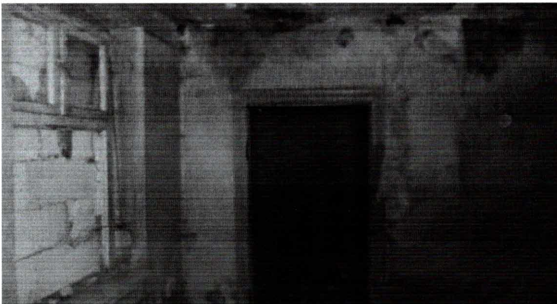
fot. nr 11 Wnętrze budynku – zawilgocenia górnych partii ścian powstałe najprawdopodobniej na skutek nieszczelności zadaszzenia, zamurowana stolarka okienna.
