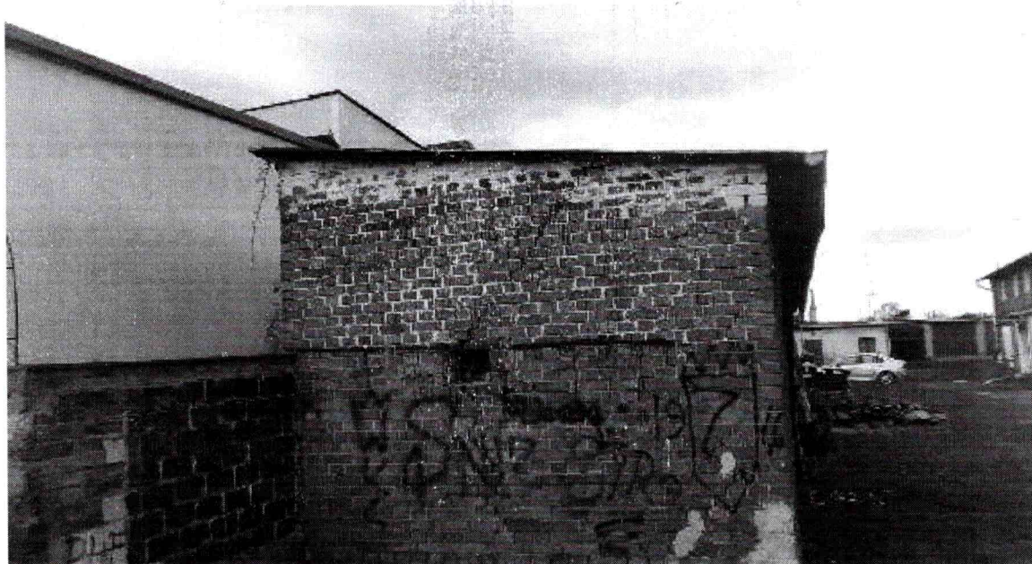
fot. nr 2 Widok obiektu od strony ściany w osi A, widoczne pęknięcie ściany w osi A nad otworem oraz ubytki tynku.
