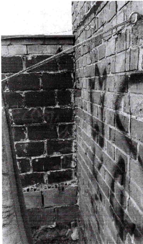
fot. nr 6 Połączenie ściany budynku przewidzianego do rozbiórki w osi A i ogrodzenia biegnącego wzdłuż krawędzi działek w osi 1. Ściany przy przecięciu osi A/1 rozbierać wyłącznie ręcznie, nie naruszając ogrodzenia murowanego na granicy działek.
