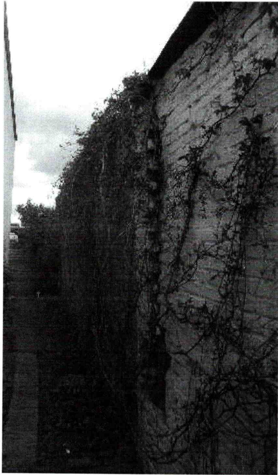
fot. nr 7 Ściana w osi 1 budynku – widoczne pęknięcie w odległości około 3 m od osi A w kierunku osi B oraz przemieszczenie muru (wypchnięcie w kierunku budynku sąsiedniego). Roślinność na terenie działki sąsiedniej do ochrony w trakcie prowadzenia robót. Winorośl porastającą ścianę przenieść na ruszt drewniany.
