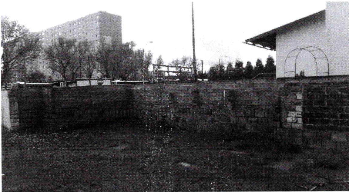
fot. nr 9 Ogrodzenie murowane przy granicy działek – przewidziane do pozostawienia i otynkowania w ramach niniejszego opracowania
