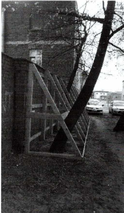
fot. nr 9 Zabezpieczenie ściany (podstemplowanie) w osi A przed utratą stateczności. Zabezpieczenie utrzymywać do momentu zakończenia rozbiórki ściany. Drzewa w bliskim sąsiedztwie budynku zabezpieczyć i ochraniać na terenie rozbiórki.
