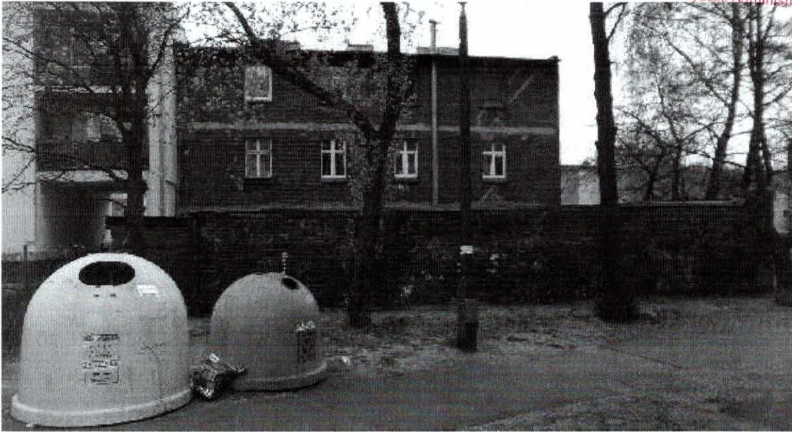
fot. nr 5 ściana w osi 1 budynku – widoczne spękania , ubytki muru, ubytki obróbek blacharskich, ugięcie połaci dachowej. Drzewa oraz ich korzenie w bliskim sąsiedztwie ściany budynku do zabezpieczenia i ochrony w trakcie robót rozbiórkowych.
