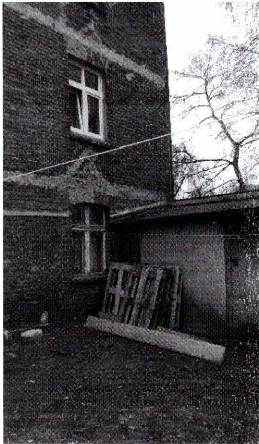
fot. nr 3 Widok miejsca połączenia budynku gospodarczego przewidzianego do rozbiórki z budynkiem frontowym – widoczne ślady naprawy konstrukcji budynku frontowego, ugięcie połaci dachowej budynku gospodarczego. Ścianę oraz okna budynku frontowego zabezpieczyć przed przystąpieniem do robót rozbiórkowych.
