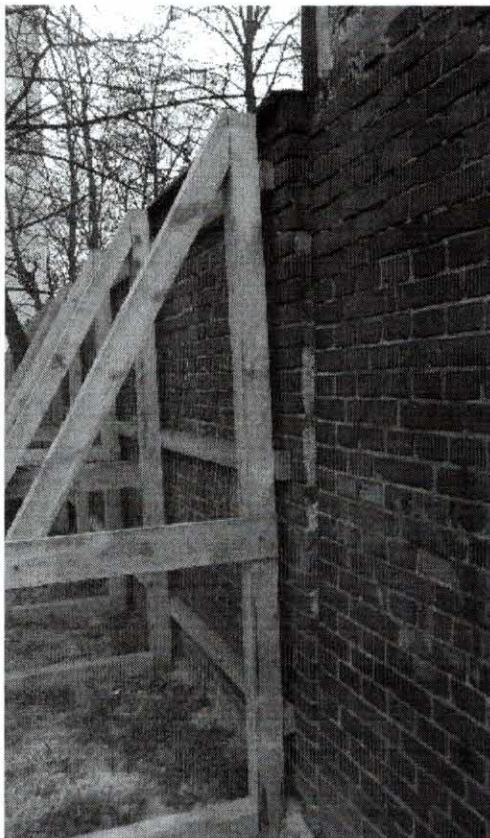
fot. nr 10 Połączenie ściany w osi A budynku gospodarczego oraz budynku frontowego (widoczna utrata pionowości ściany budynku gospodarczego).
