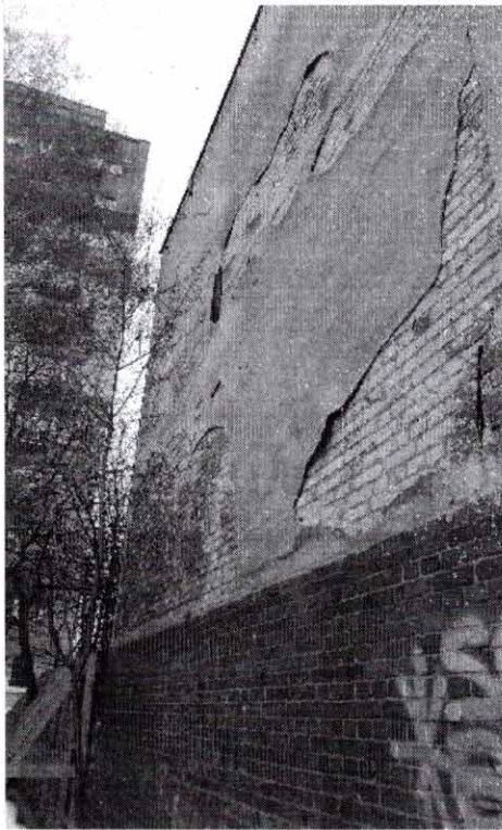
fot. nr 11 Ściana budynku frontowego – kontynuacja ściany w osi A – ubytek tynku w około 50%, pozostały tynk odspojony od elewacji, grożący oderwaniem od elewacji.
