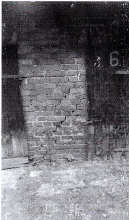
fot. nr 4 Spękana ściana zewnętrzna budynku gospodarczego przewidzianego do rozbiórki w osi nr 3.
