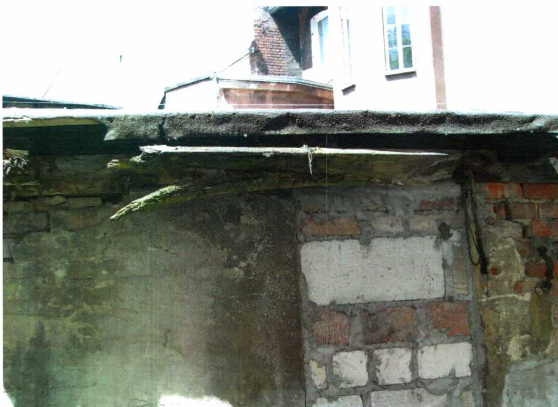
Foto.4 Spróchniała konstrukcja dachu
