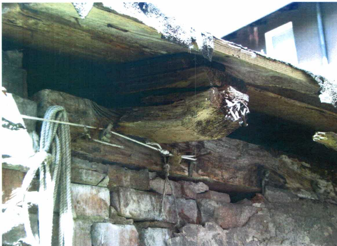
Foto.5 Spróchniała konstrukcja dachu
