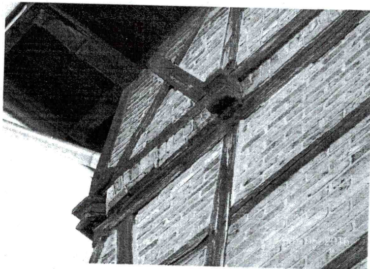
Fot.7. Zniszczony północno – zachodni narożnik domu.
