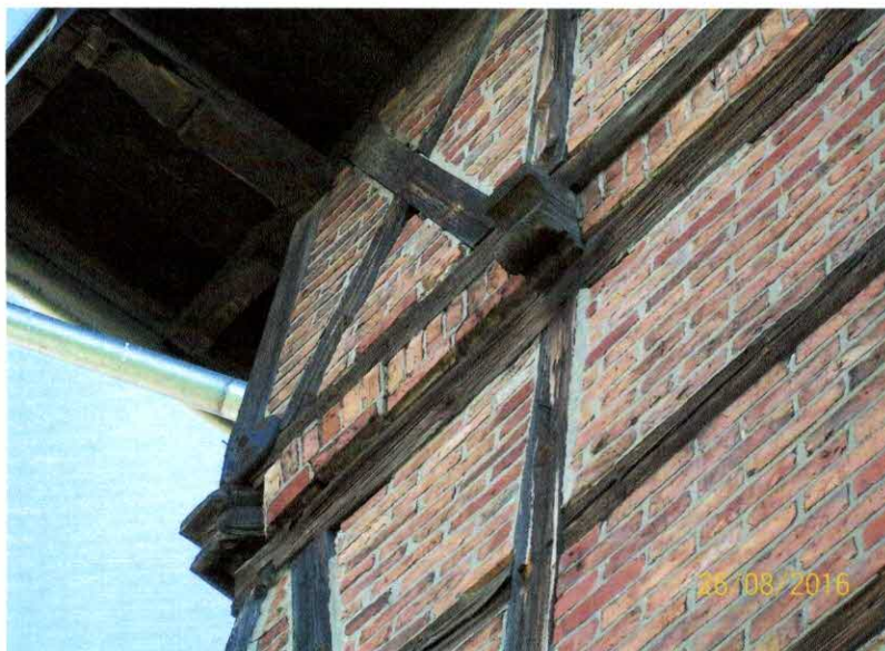
Fot.7. Zniszczony północno – zachodni narożnik domu.
