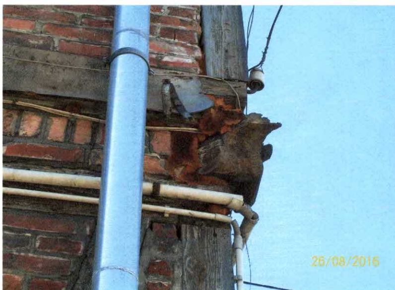
Fot.8. Uszkodzony narożnik północno – wschodni budynku.
