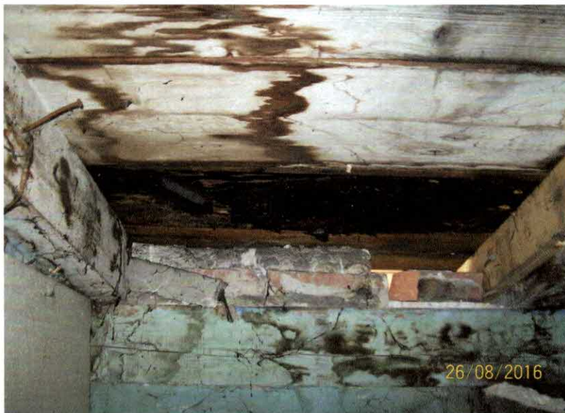
Fot.11. Zniszczona ściana poddasza.
