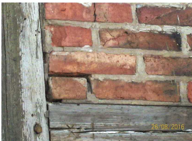
Fot.12. Obluzowane cegły w ścianie zewnętrznej budynku.
