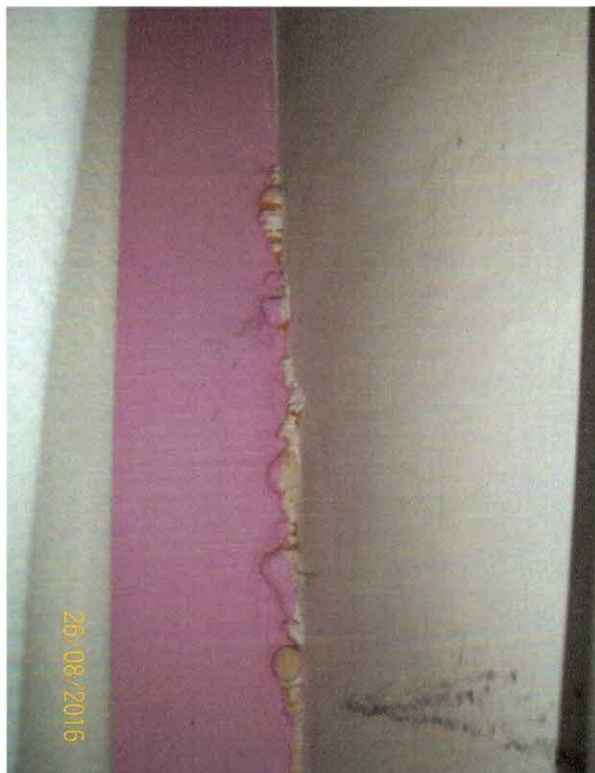
Fot.10. Pęknięcie narożnika ściany wypełnione pianką poliuretanową w mieszkaniu nr 1.
