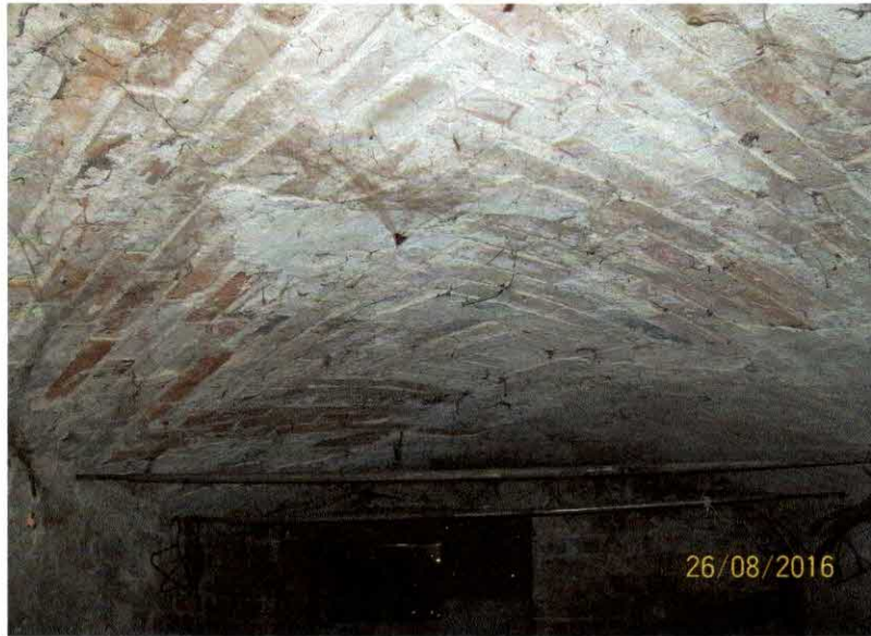
Fot.15. Ubytki tynków na powierzchni sufitów.
