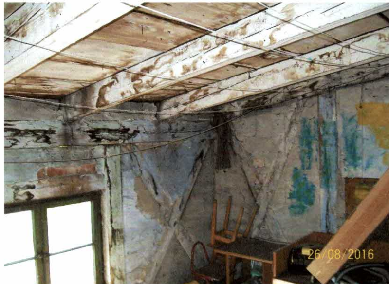
Fot.14. Zacieki na powierzchni drewnianych elementów więźby.
