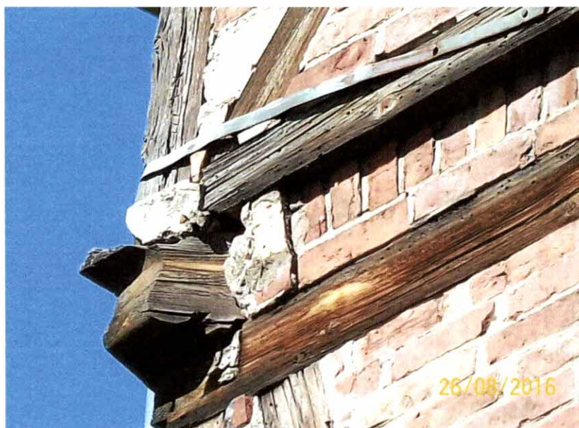
Fot.9. Uszkodzony narożnik południowo – zachodni budynku.
