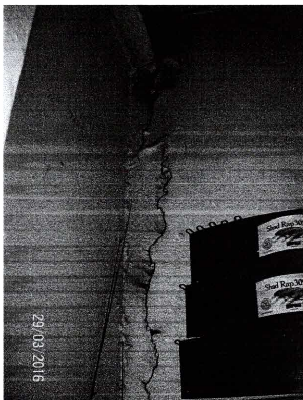
Fot.12. Pęknięcie ściany zaplecza graniczącej z klatką schodową.
