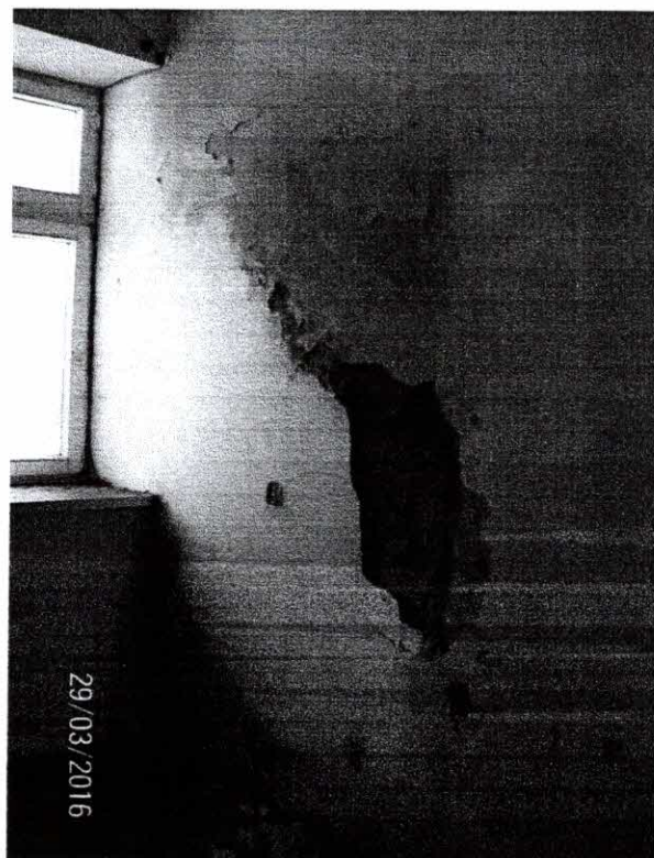
Fot.7. Mokra ściana południowa w kuchni lokalu nr 1.
