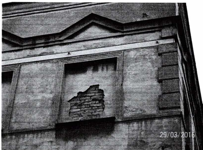
Fot.17. Ubytki tynku na elewacji frontowej.
