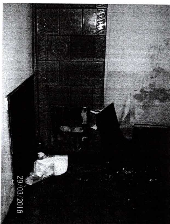
Fot.10. Zniszczony piec kaflowy w mieszkaniu nr 1.
