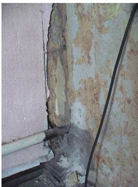
uszkodzenia słupów drewnianych
